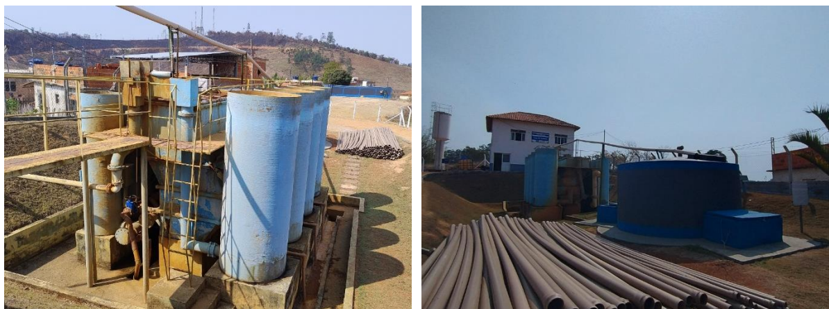
Figura 63: Estação de Tratamento de Água (ETA) Divinésia.
